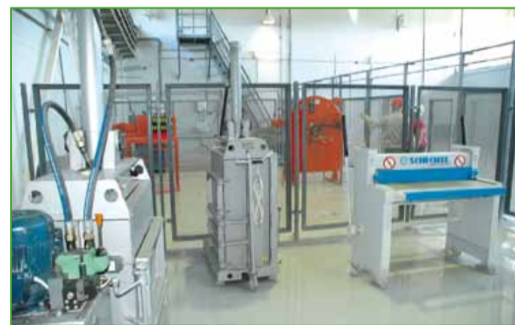
Производственный корпус. Станочное оборудование по переработке отходов
